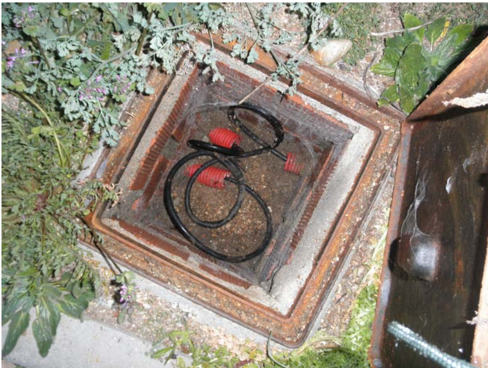
Arqueta de alumbrado existente
